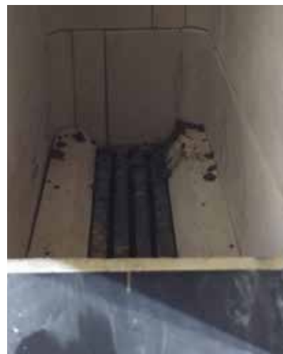
Pohled do topeniště s litinovým roštem.
